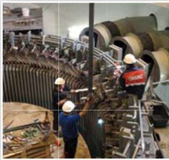
Fig. 6 : diagnostic et réhabilitation d'un alternateur
